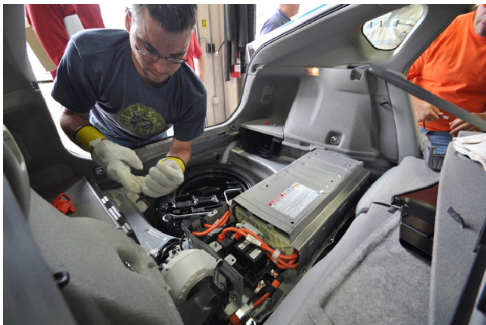
■ Las marcas recomiendan sustituir en lugar de reparar o acondicionar baterías para vehículos eléctricos-híbridos.
